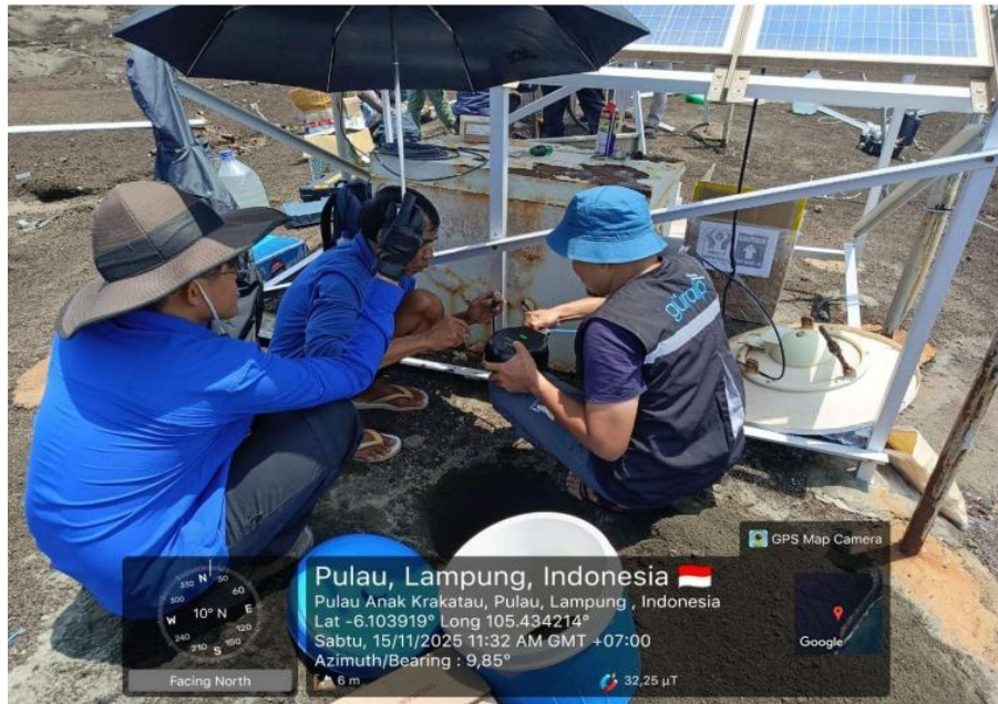
Gambar 6. Instalasi Peralatan Sistem Mitigasi Bencana Geologi Pulau Anak Krakatau, Prov. Lampung
